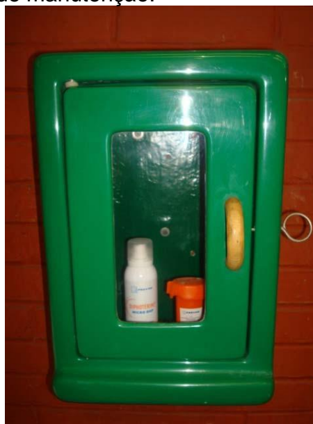
Figura 09: Estação de descontaminação ativa para olhos e membros Cada uma das unidades acima mencionadas possui lacre com 'tag' para identificação, controle de utilização e validade. Além deste, há sucinto descritivo de orientação quanto à forma de aplicação dos produtos.
